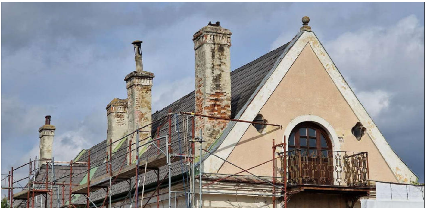
^ Vorzustand der Kamine mit desolaten Kaminköpfen und fehlenden Kaminaufsätzen
