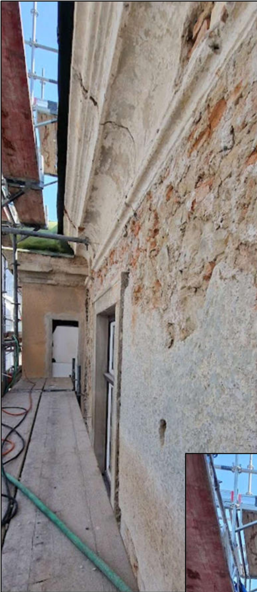
^ Außenfassade 1. OG: Freilegung von desolaten Putzauflagen
